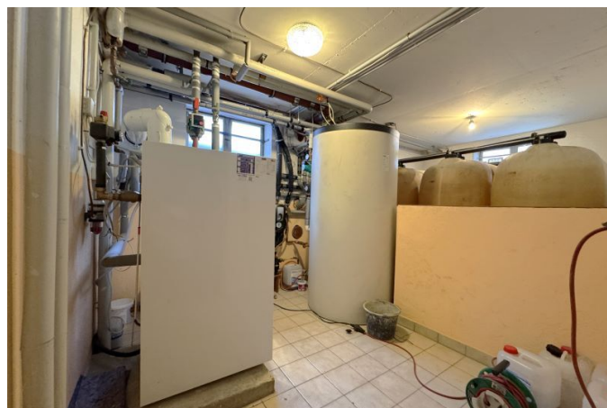
Im Merheimer Lehm 11_Heizungskeller
